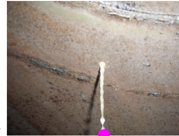
地下タンクからの漏洩
