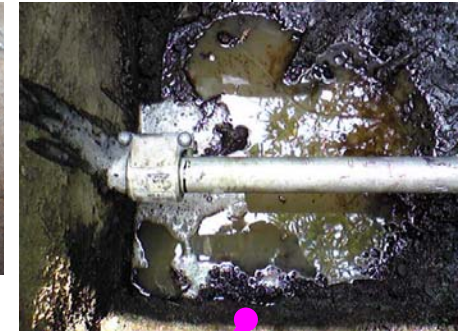
配管からの漏洩
